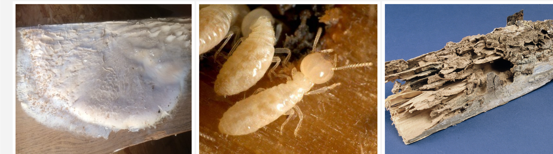
Exemples de dégâts causés par les champignons et termites
